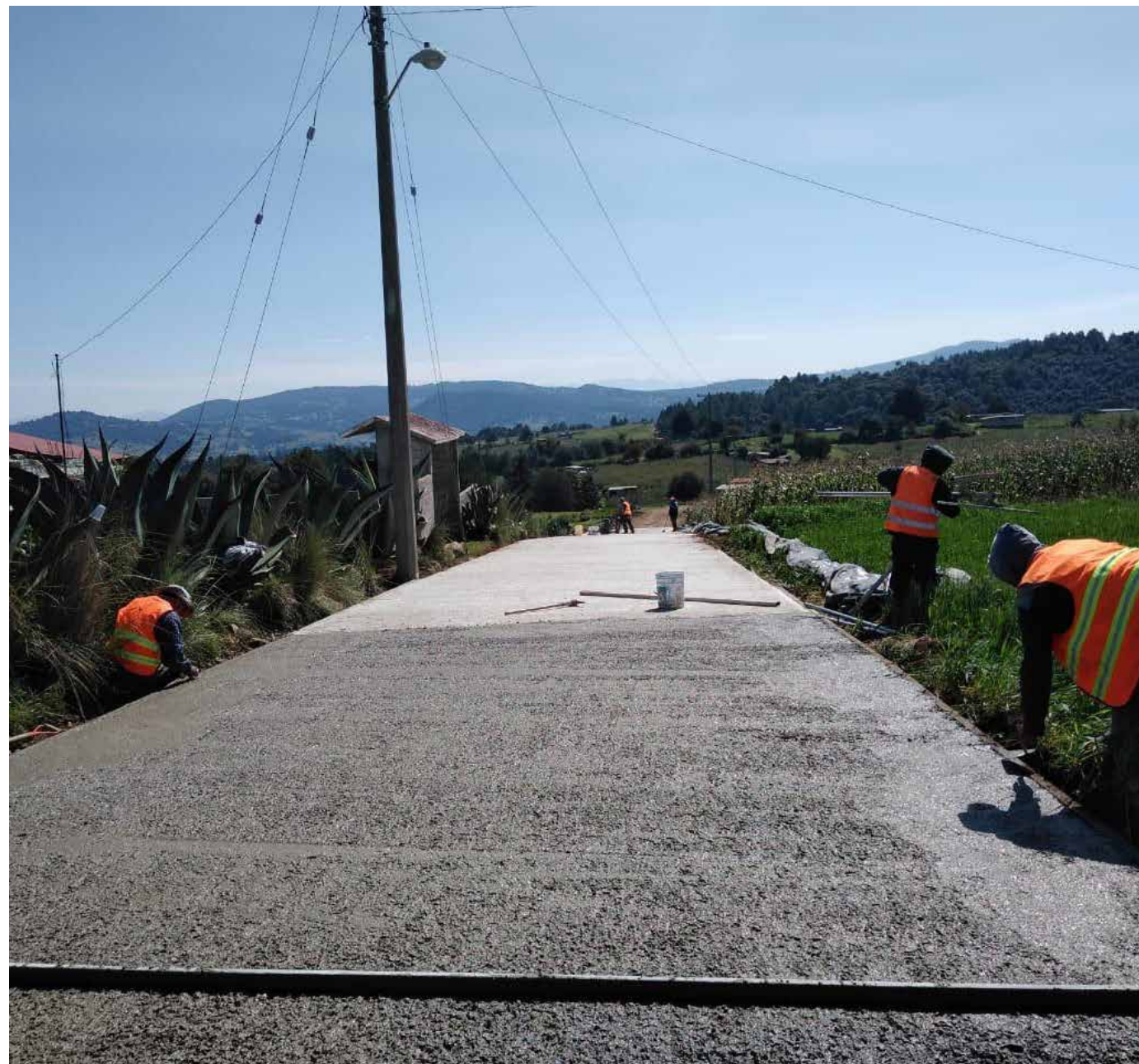
En la comunidad de SAN MIGUEL LA LABOR se realizó la REHABILITACIÓN DEL CAMINO PRINCIPAL a base de concreto asfáltico, con una inversión de $7,894,138.99.
